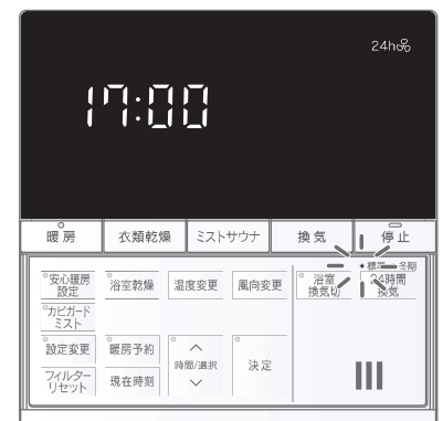
(脱衣室リモコン)
